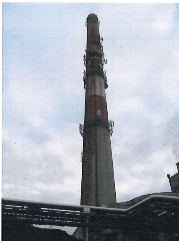
Zał. nr 1: Widok ogólny instalacji radiokomunikacyjnej.
