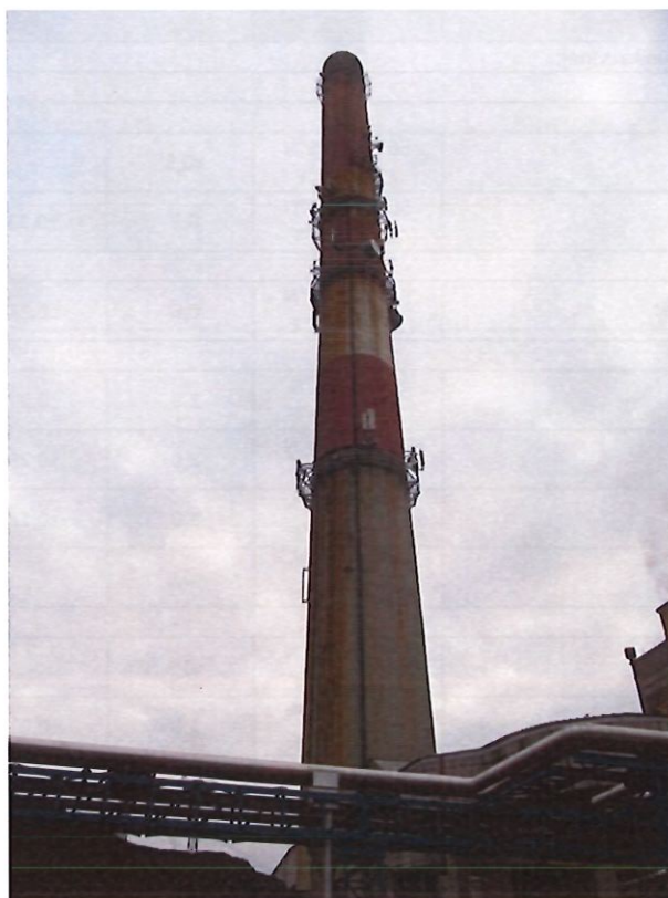
Zal. nr 1: Widok ogólny instalacji radiokomunikacyjnej.
