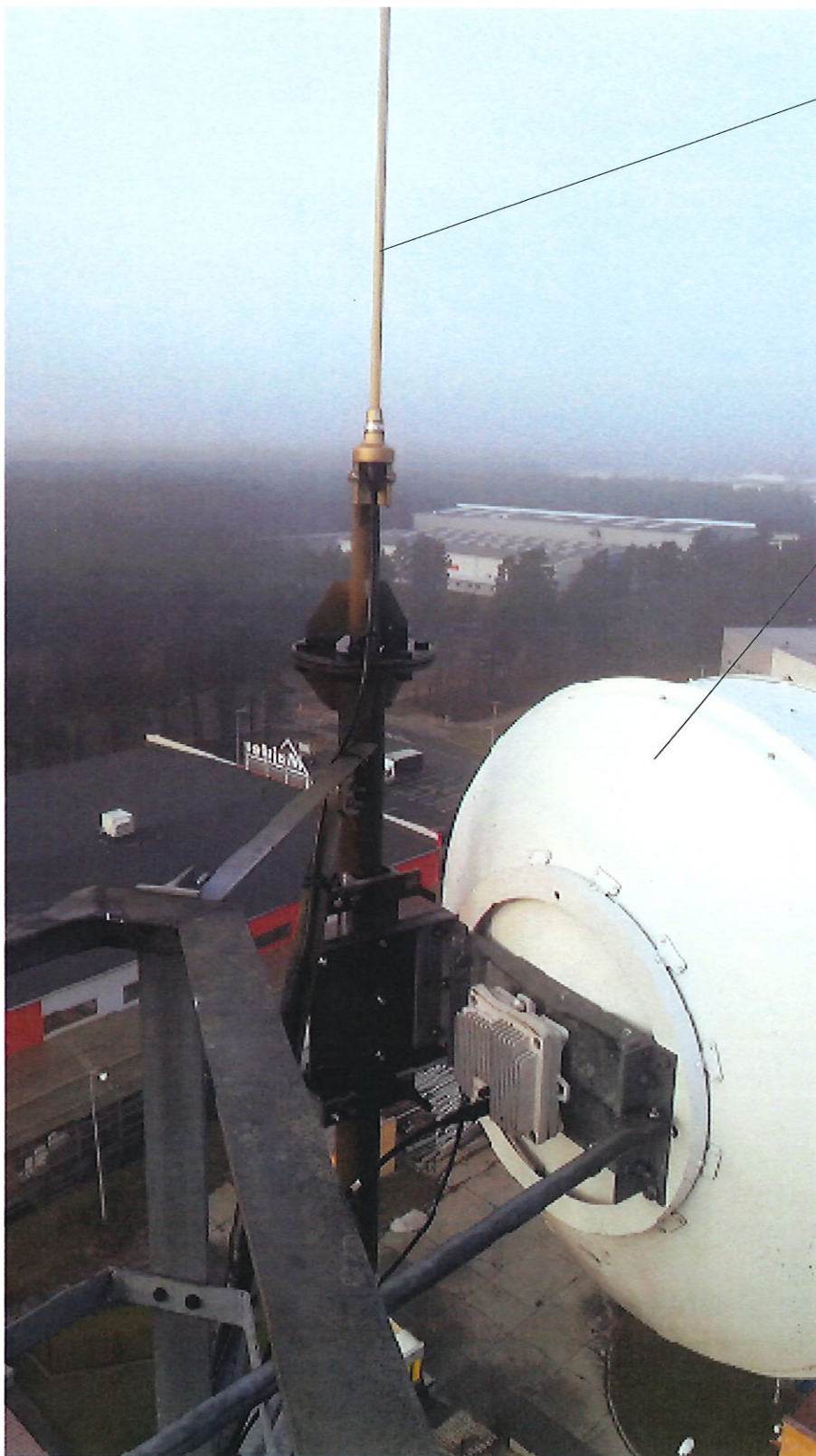
Antena istniejącej stacji bazowej typu Kathrein K7515211
