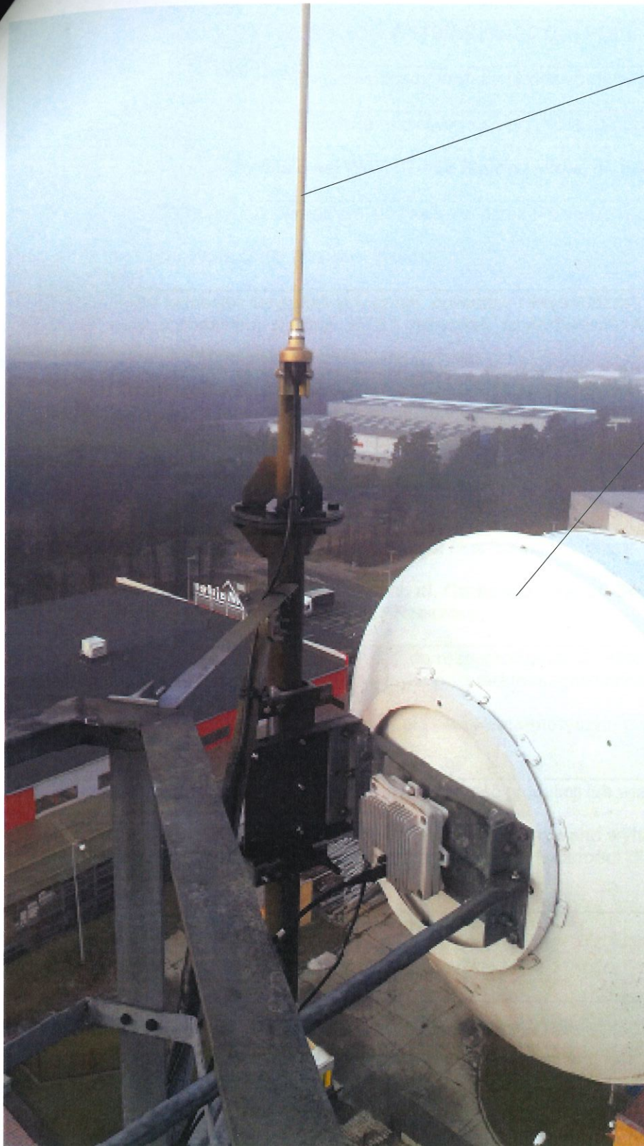
Antena istniejącej stacji bazowej typu Kathrein K7515211
